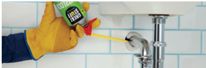
Penetración de plomerías
