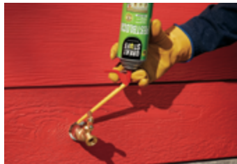
Penetración del grifo del agua
