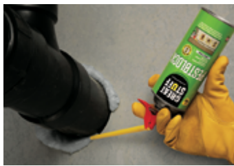
Penetración de tubos de PVC
